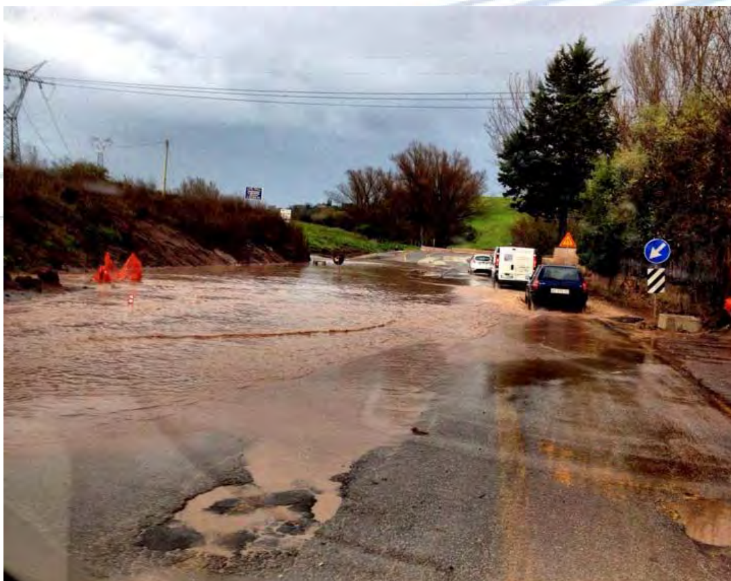
Foto 10 – Allagamento di tutta la sede stradale
